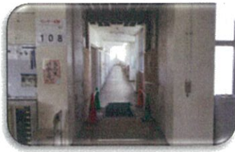
床や壁面に亀裂（コーンあり）
