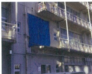
使用不可となっている校舎の外壁のようす
